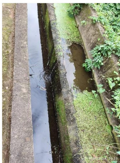
Figura 7 - Calha longitudinal de saída do efluente tratado (10 de agosto de 2024)
