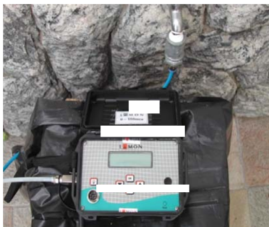
Figura 3- Medidores de pressão com armazenador de dados instalados em pontos diferentes de monitoramento
