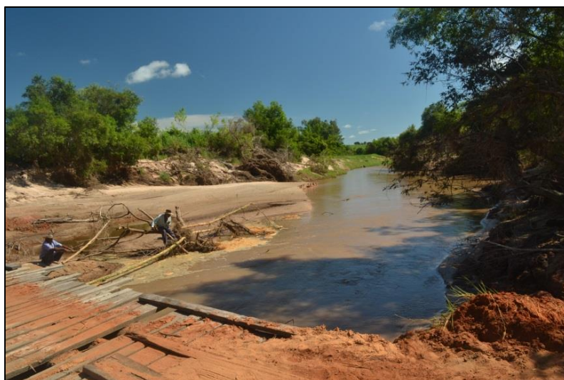
Figura 5 - Depósitos de assoreamento no ribeirão Taquaruçu ou Santo Antônio na bacia do rio do Peixe (Fonte: IPT, 2017).
