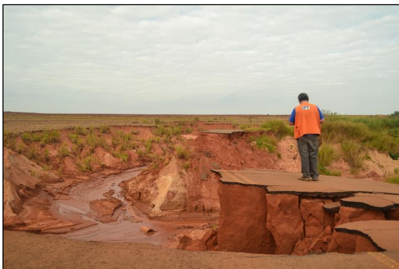
Figura 4 – Erosão do tipo boçoroca de grande dimensão em área rural e provocou o rompimento da estrada vicinal pavimentada (Fonte: IPT, 2017).
