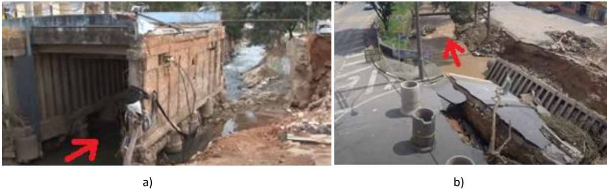
Figura 5 –Pontes colapsadas, com setas indicando o sentido do escoamento a) Cruzeiro e b) Faculdade (fonte: Dias (2016); adaptado de Itatiba (2016a))
