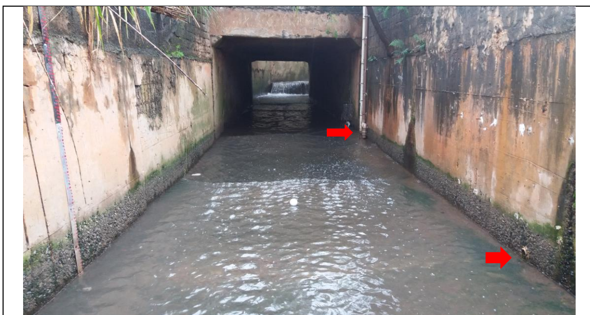
Figura 02 – Local na Galeria de drenagem onde os equipamentos foram instalados.
