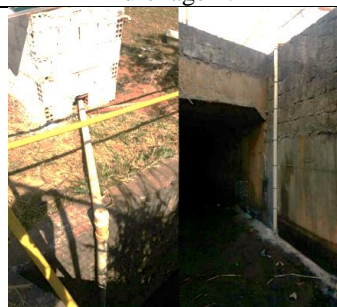
Figura 06 – Detalhes da conexão do amostrador a galeria.
