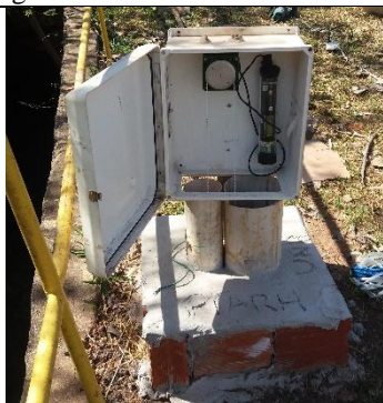
Figura 03 – Detalhe do Linígrafo de boia instalado.
