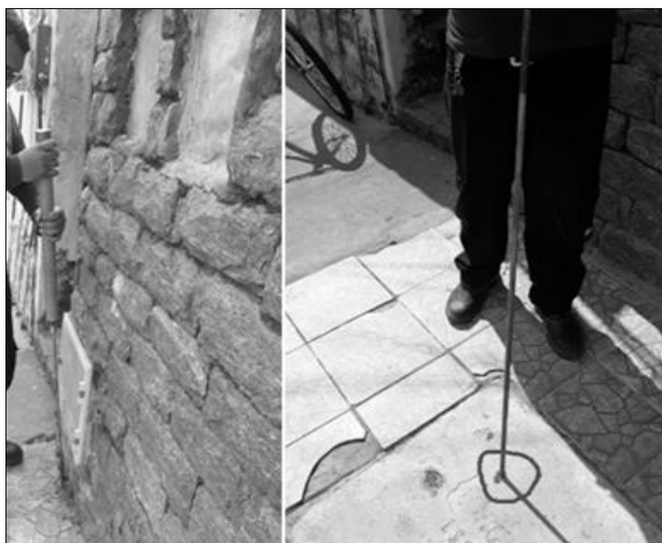
Figura 6 - Confirmação do vazamento com sondagem.
