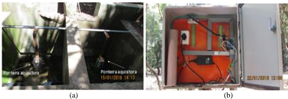
Figura 9 – Ponteira aquisitora e caixa da parte elétrica do sistema. Foto: autores
