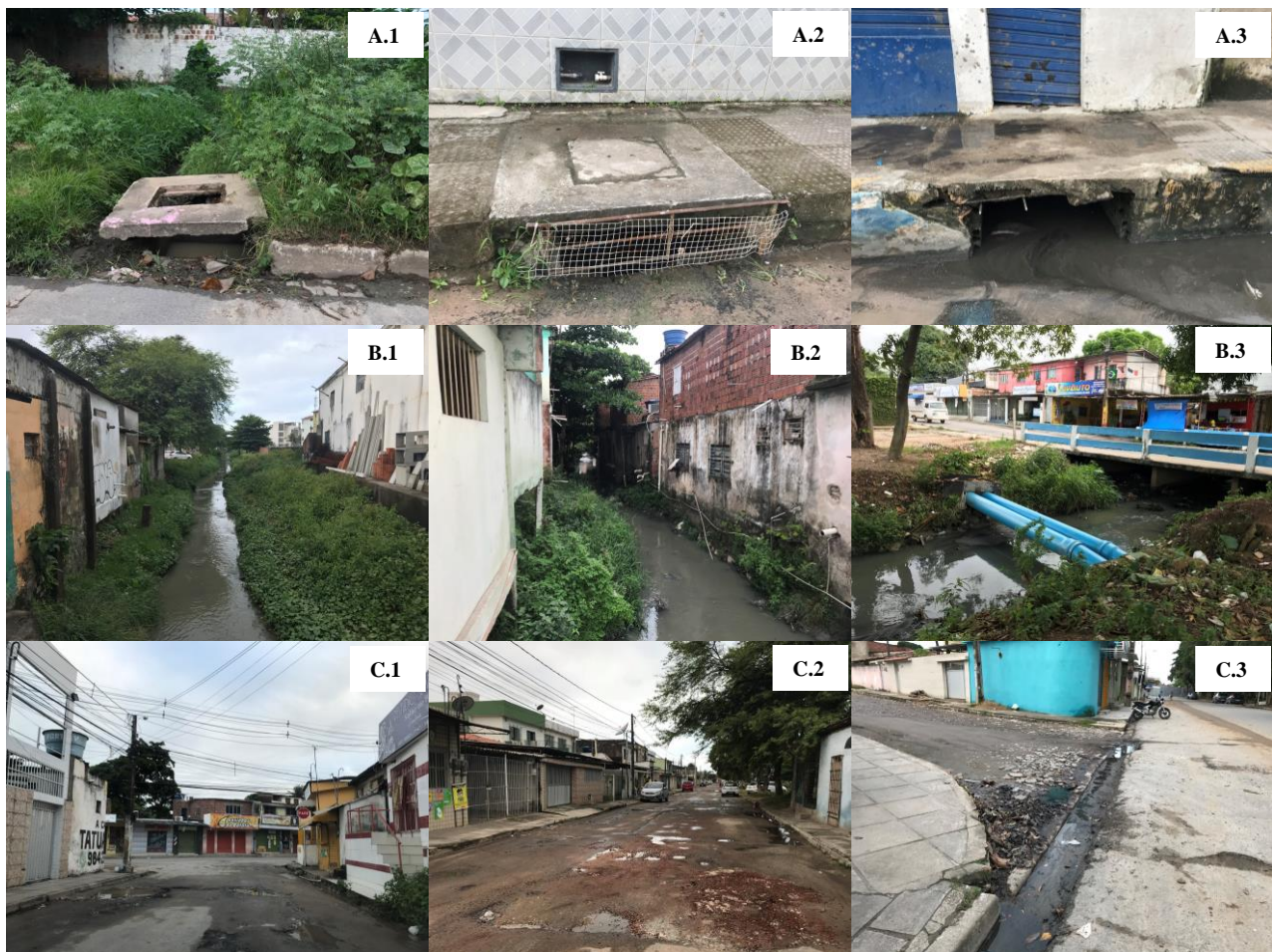
Figura 2 - (A.1, A.2, A.3) Deterioração das bocas de lobo e ausência de padronização; (B.1, B.2, B.3) Presença de ocupações ribeirinhas, vegetação, esgoto e interferência por adutoras; (C.1, C.2, C.3) Erosão dos acessos e vias principais.
