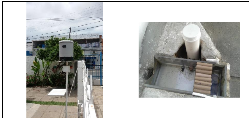
Figura 2 – Vertedor e pluviômetro instalados no lote.
