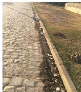
Figura 4 – Área com esgoto a céu aberto em rua calçada no bairro Sebastião Maltez
