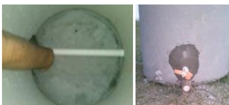
Figura 2 – Drenagem de base e Registro de controle do lixiviado.
