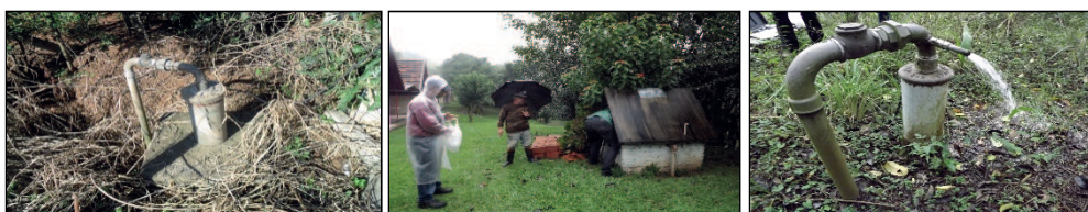
Figura 04: Pontos de Coleta Nº 08, 13 e 22 – com perímetro de proteção inadequado, precário ou ausente. Fonte: Acervo dos autores.
