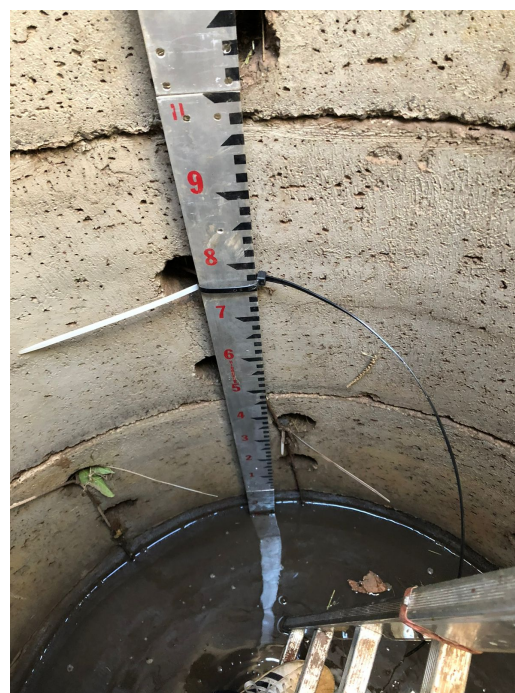
Figure 8: Poço de infiltração - detalhe da régua linimétrica e nível d'água.
