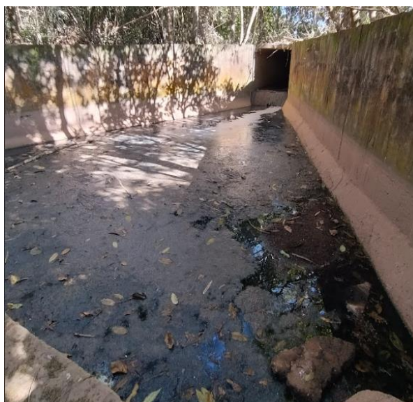
Figura 2 – Evidências visuais de efluente líquido irregular na galeria de águas pluviais durante a fiscalização primária (Adasa, 2025).
