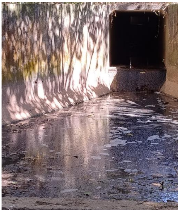
Figura 5 – Lançamento irregular corrigido (Adasa, 2025).
