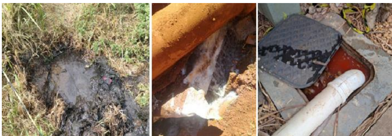
Figura 3 – Identificação de anomalias na infraestrutura: poço de visita obstruído e infiltrações de esgoto na rede de drenagem (CAESB, 2025).
