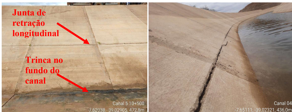
Figura 3 – Pontos de vazamento: (a) trinca no fundo do canal; (b) junta de retração trincada.
