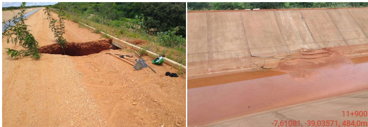
Figura 4 – Patologias geotécnicas e danos ao revestimento: (a) recalque na berma do canal; (b) escorregamento de solo para a seção hidráulica com comprometimento da proteção mecânica.
