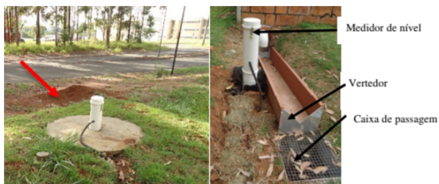
Figura 3 – Poço de infiltração da Prefeitura Municipal de São Carlos – detalhes de funcionamento. Fonte: Ferreira, 2016.
