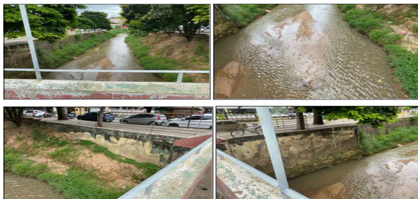
Figura 4 - Ponto escolhido para a medição da capacidade hidráulica
