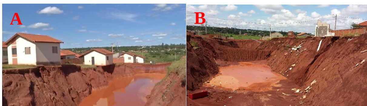
Figura 4 Residências impactadas pela erosão urbana. A imagem mostra as casas em risco iminente de desabamento (A) e outra residência já colapsada pela voçoroca (B).
