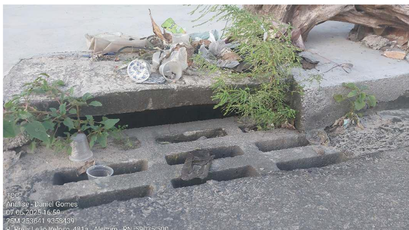
Figura 3 – Condições de manutenção das bocas de lobo na área de estudo.
