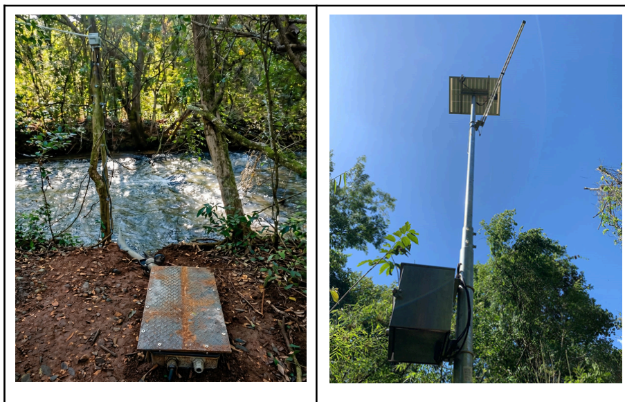
Figura 4. A infraestrutura consiste na caixa de passagem da sonda, que inclui a tubulação (ilustrada à esquerda), o painel de telemetria e o sistema fotovoltaico, utilizado para o fornecimento de energia (imagem à direita). Fonte: O autor 2026.
