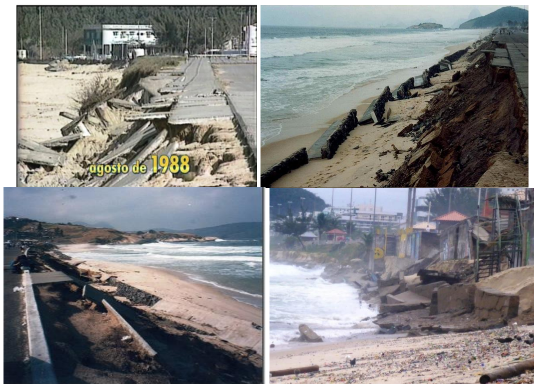
Figura 2 – Erosão e avarias na murada (em sentido horário: setor oeste 1988, setor central 2004; setor leste 1999 e leste 2016).
