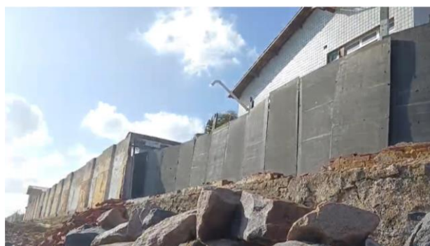
Figura 3 - Muro das residências derrubados na Praia do Icaraí. Fonte: Própria, 2025.
