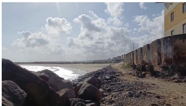
Figura 2 – Um dos espigões que foram construídos na Praia do Icaraí, como também um condomínio a menos de 5m da praia. Fonte: Própria, 2025.
