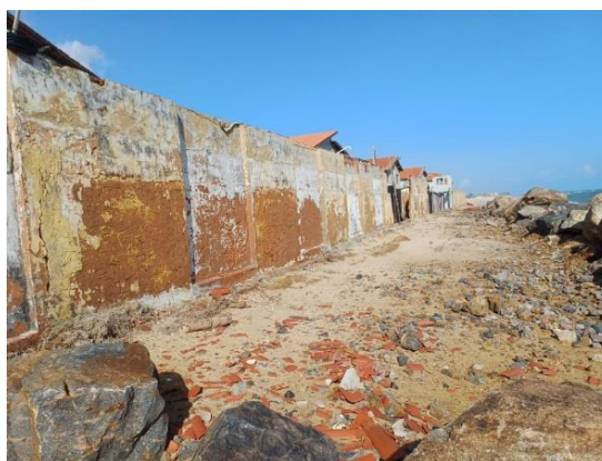
Figura 4 - Parte do muro de um condomínio de casas na Praia do Cumbuco. Fonte: Própria, 2025.
