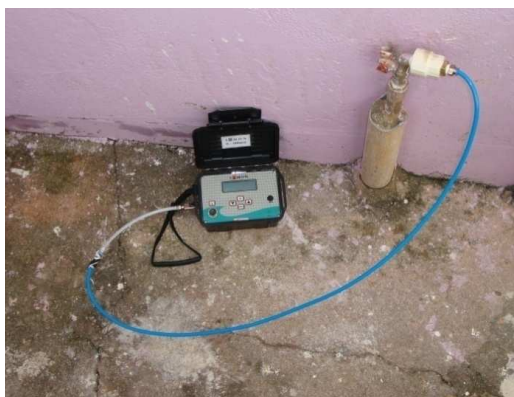
Figura 4 - Medidor de pressão com armazenador de dados instalados em pontos diferentes de monitoramento
