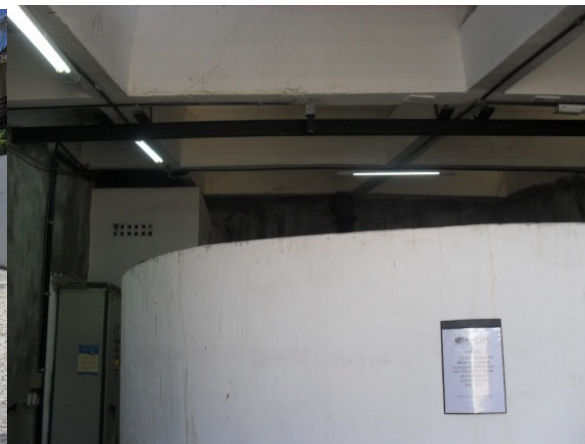
Figura 3 – poço de sucção EE4
