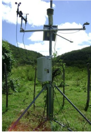
Figura 2: Estação climatológica automática Campbell Scientific instalada na Bacia do Alto Ipanema.
