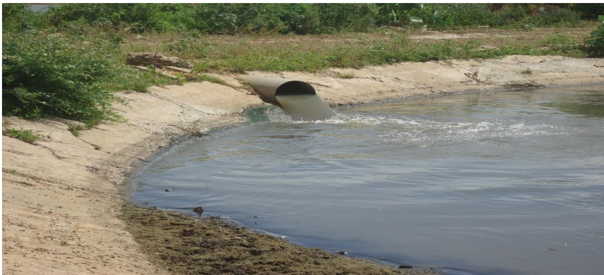
Figura 10 - Entrada do esgoto na lagoa facultativa. Fonte: Autoria própria, 2011.
