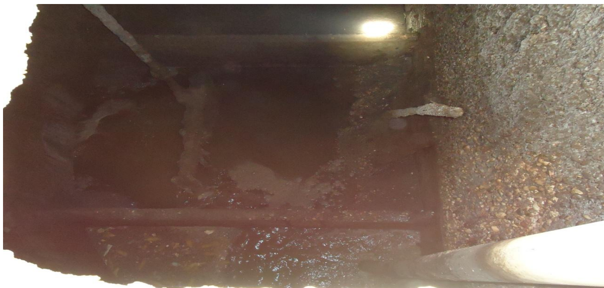
Figura 12 - Gradeamento da estação elevatória I. Fonte: Autoria própria, 2011.
