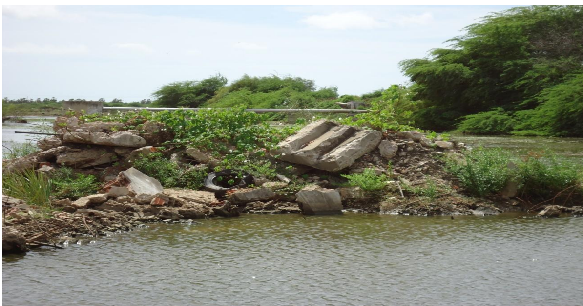
Figura 11 - Restos do gradeamento e da caixa de areia. Fonte: Autoria própria, 2011.
