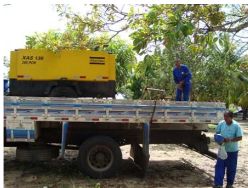
Figura 7 – Compressor utilizado no air-lift .
