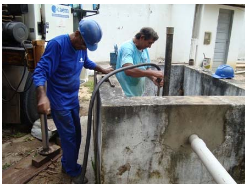
Figura 10 – Mangueira do compressor.
