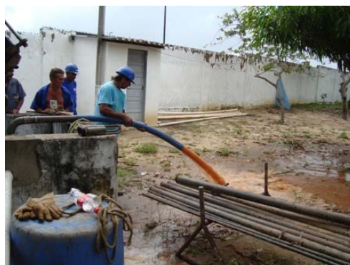
Figura 11 – Bombeamento da água ferruginosa pela tubulação de 2\frac{1}{2} .
