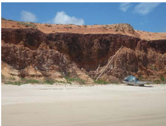
Figura 13 – Falésia com processo de desmoronamentos na praia de Zumbi/RN.
