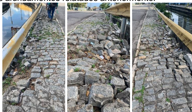
Figura 7. Exemplos de afundamentos triplos Fonte: Os autores
