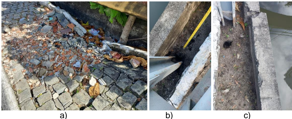
Figura 10. Resíduos sólidos(a) afundamento de solo junto a defesa metálica(b) e presença de formigueiros.
