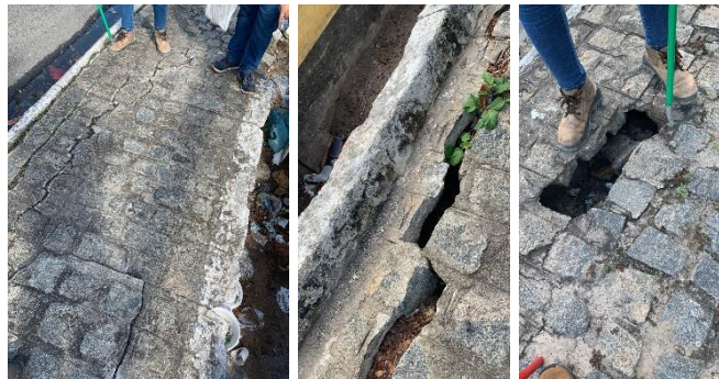
Figura 9. Trincas, indicando arraste do solo sem afundamento da calçada.
