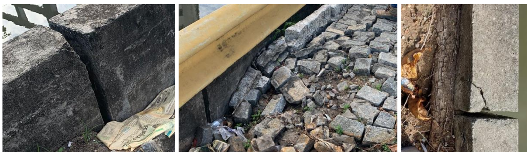
Figura 3. Espaço entre placas de concreto por onde ocorre o arraste de sedimentos (solo) pela chuva para o interior do canal.
