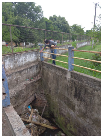
Figura 5: Trecho do canal do riacho São Francisco com presença de resíduos sólidos acumulados e estreitamento da passagem da água.
