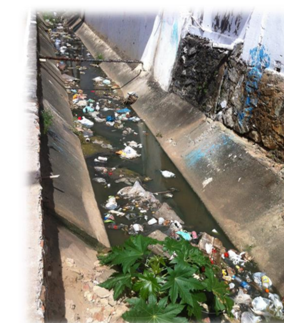
Figura 2: Disposição inadequada de Resíduos sólidos no canal
