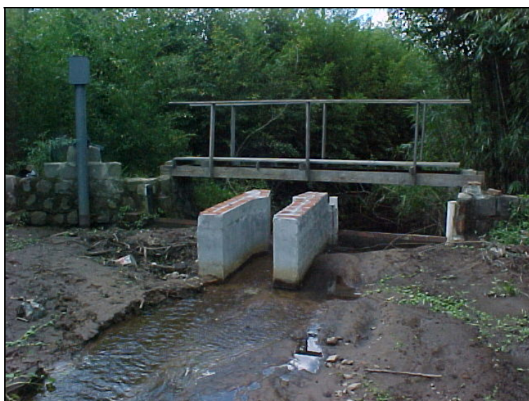
Figura 07 - Calha de fundo plano, instalada na estação fluviométrica Sítio do Tio Pedro, Santa Maria/RS.
