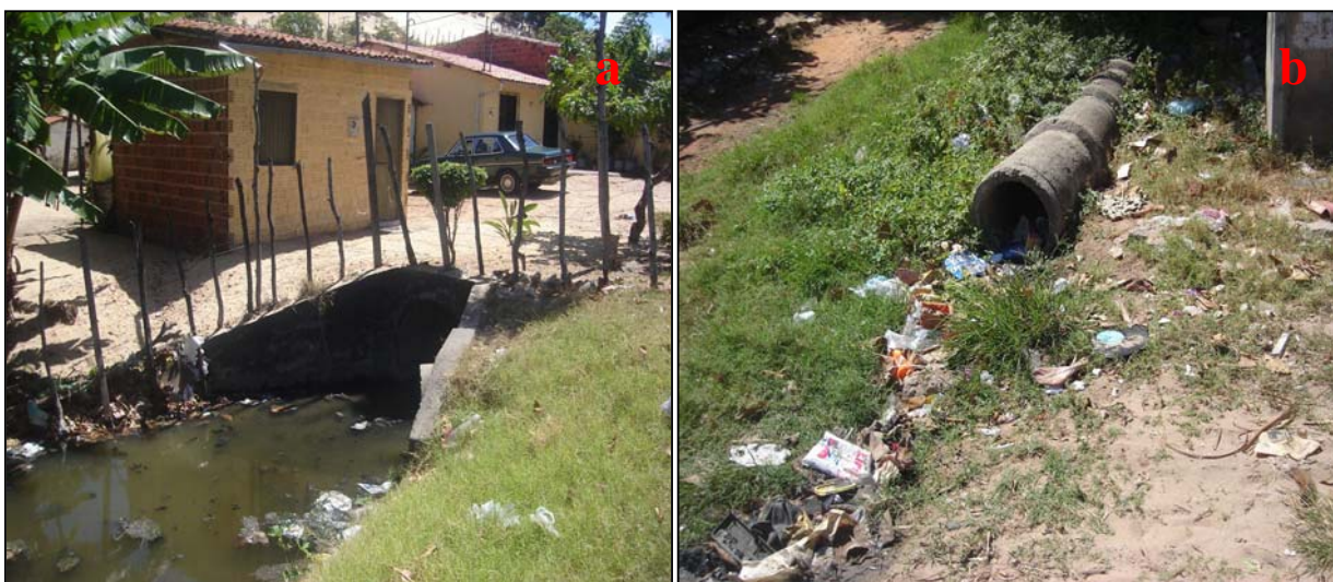
Figura 8 (a) e (b) – Precariedade de Esgotamento Sanitário no Morro Santa Terezinha.
