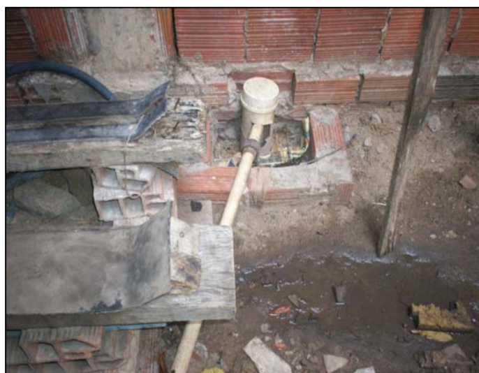
Figura 4 - Poço P86, onde são observadas as más condições de preservação e manutenção do entorno do poço.
