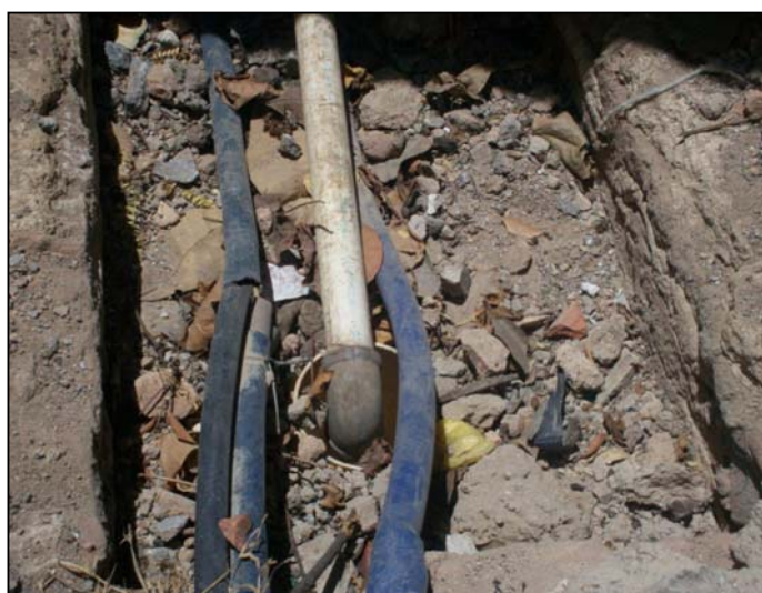
Figura 5 – Poço P12, localizado num campo de futebol da Comunidade, não apresentando as condições mínimas das normas técnicas da ABNT (NB-1290).
