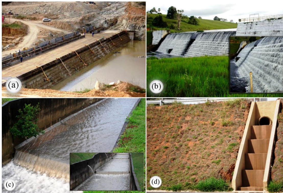
Figura 1 – Barragem Cristalândia, Bahia (a) e Barragem Rio da Dona, Bahia (b) (imagens (a) e (b) cedidas por Antônio Gilberto Simões de Oliveira e Paulo Roberto M. Simões)
