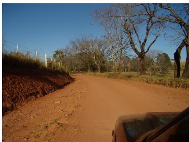
Figura 15.a – Foto de um trecho da estrada PSP-428, antes das obras de adequação (29/06/2007).
