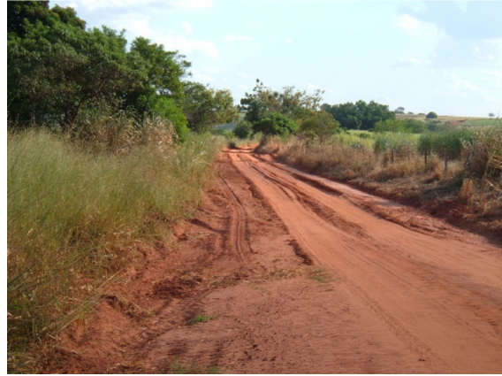
Figura 6 - Foto de um trecho da obra indicando que a estrada não possuía um sistema eficiente de captação de água e destinação adequado (20/04/2007).
