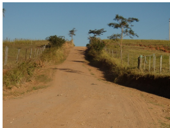
Figura 9 - Trecho da estrada na qual verifica-se que a rampa possui uma alta declividade facilitando o aumento da velocidade das águas pluviais (29/06/2007).
