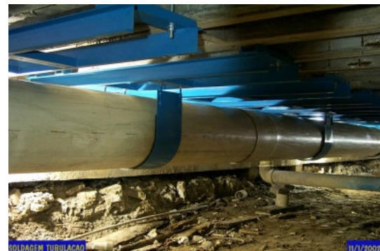
Figura 11.- Vista da tubulação de compensação de nível
