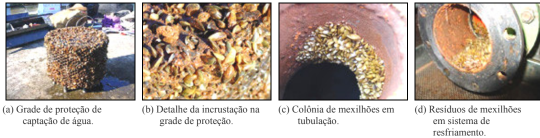
Figura 4: Detalhes de incrustações de Limnoperna fortunei em estruturas hidráulicas. Autor: Rodrigo Di Fillipo.
