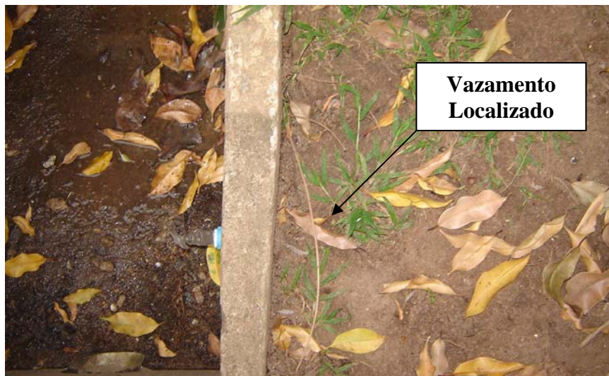
Figura 9 – Local de Vazamento Localizado Próximo ao Prédio ICE-UNIFEI (2006).
