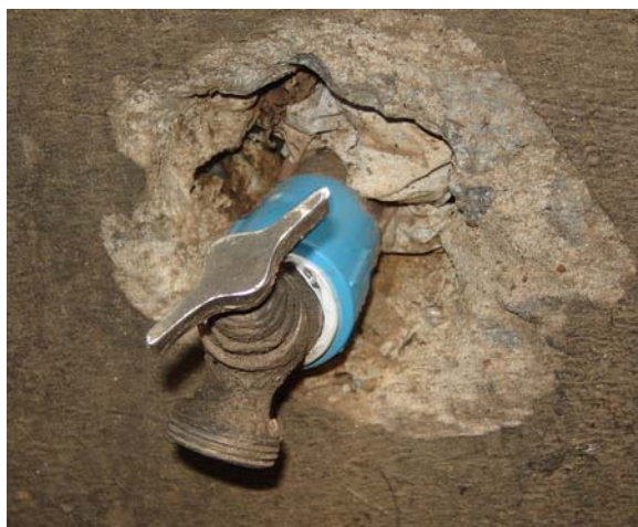
Figura 10 – Vazamento Localizado e Reparado (2006).
