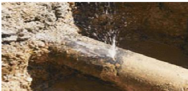
Figura 4 – Vazamento em Tubulação Rompida (LAMON, 2006).
