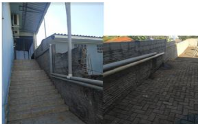
Figura 2 - Calhas e condutores existentes na CMEI
