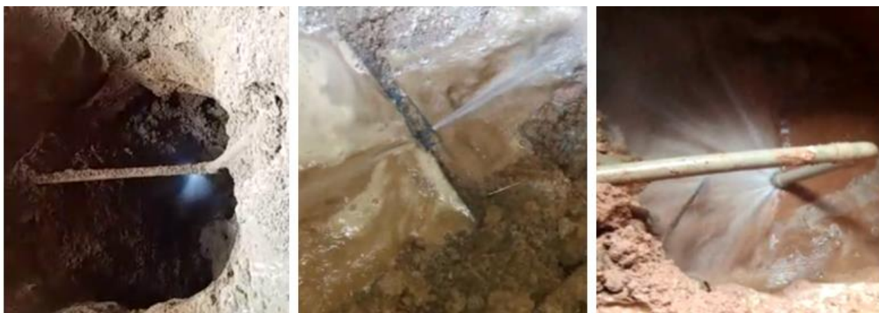
Figura 4 - Vazamentos identificados e reparados. (Fonte: CAESB, 2019).
