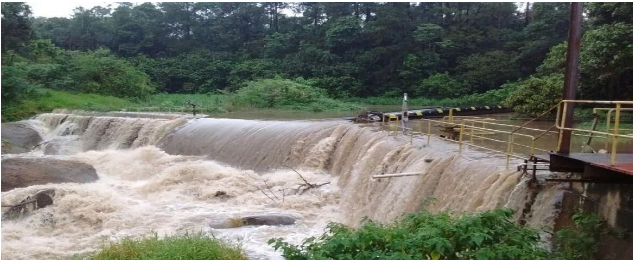
Figura 7 – Barreira de contenção flutuante operando após fortes chuvas na captação baixo Cotia.
