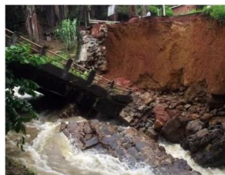
Figura 2 - Registro do colapso de uma ponte de acesso principal ao município em Dezembro de 2014
