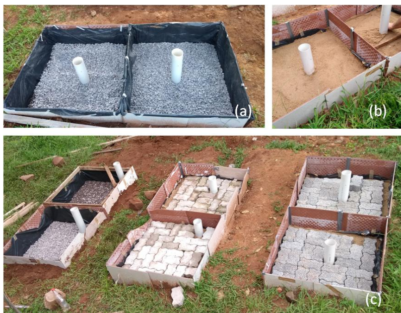
Figura 2 – Etapas de construção. (a) colocação da brita; (b) camada de assentamento; (c) revestimentos com blocos intertravados.
