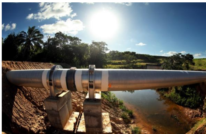
Figura 1: Trecho da Adutora do Poxim-Açu ligando a barragem Jaime Umbelino de Souza (do rio Poxim) à estação de tratamento (ETA) do Poxim, localizada próximo ao campus da UFS (Universidade Federal de Sergipe), no município de São Cristóvão, no estado de Sergipe. Fonte: ASN (2017).
